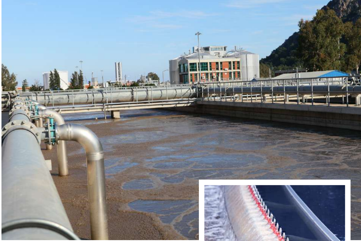
Atıksu Arıtma Tesislerimizin Tamamı Biyolojik Arıtma olup atıksuların tamamı İleri Seviyede arıtılmaktadır. (Azot ve Fosfor Giderimi)
