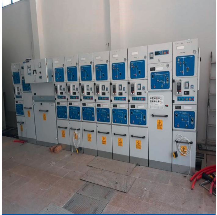
Su Üretim O.G. Elektrik Hücreleri
