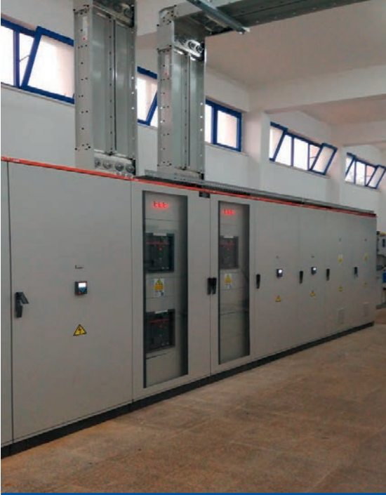
Su Üretim A.G. Elektrik Panoları
