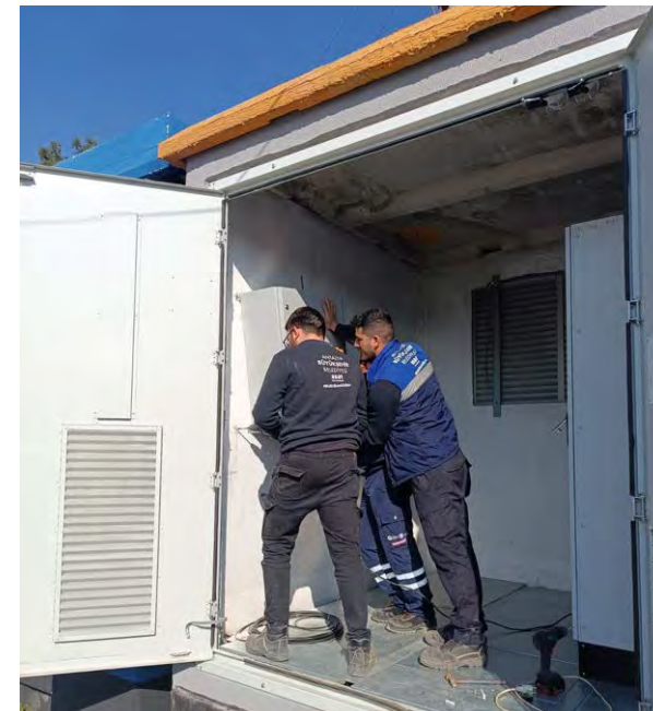
ON100 Rtu pano 380v enerji verilme çalışmaları
