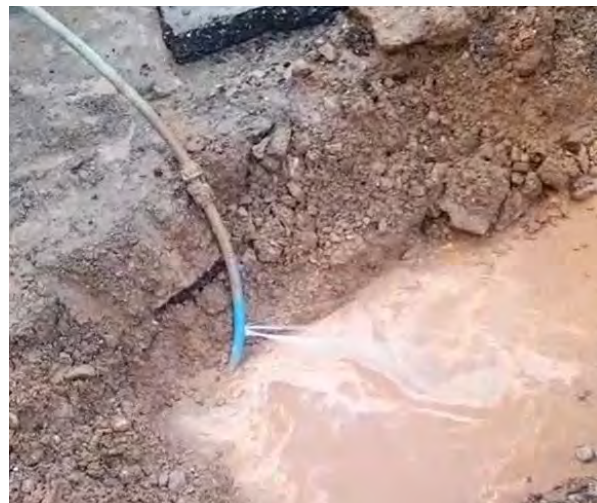
Muratpaşa İlçesi, Muratpaşa Mahallesi, Çatalköprü Caddesi, Ø25 HDPE abone borusu arıza tespiti.
