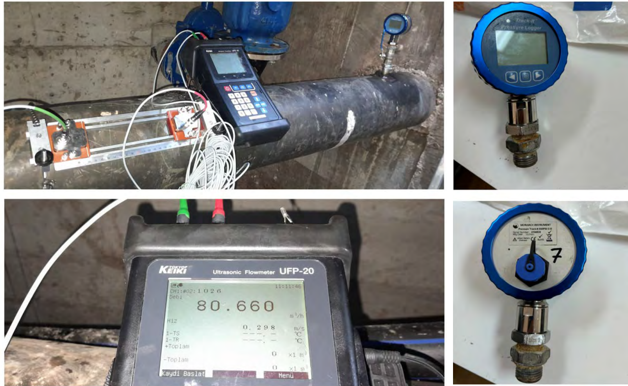
IPA Projesi kapsamında çalışmalarda aktif fiziki kaçak arama çalışmaları ile tespit edilen arızalar
