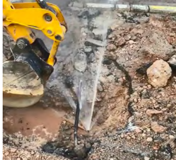
Kepez İlçesi, Ahatlı Mahallesi 3112 Sokak Ø40mm PE abone borusu arıza tespiti.
