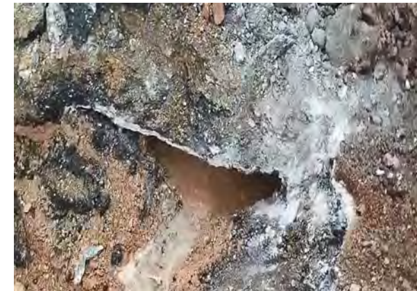
Aksu İlçesi, Güzelyurt Mahallesi, Ø160mm HDPE arıza tespiti.
