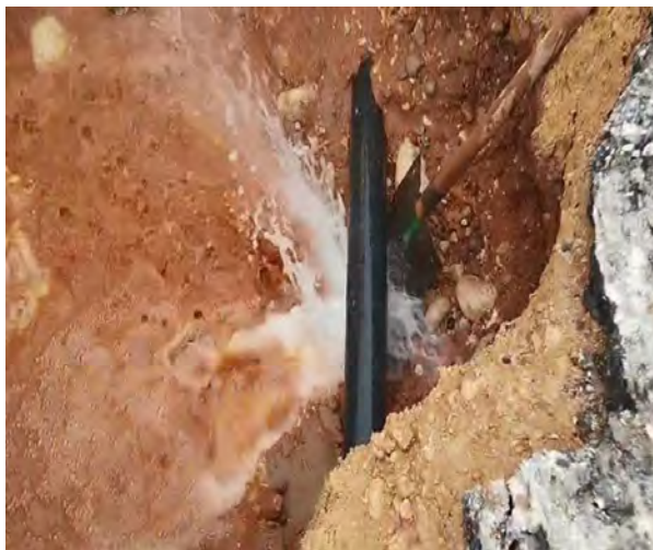
Kepez İlçesi, Yenidoğan Mahallesi Ø110'luk HDPE yank arıza tespiti.
