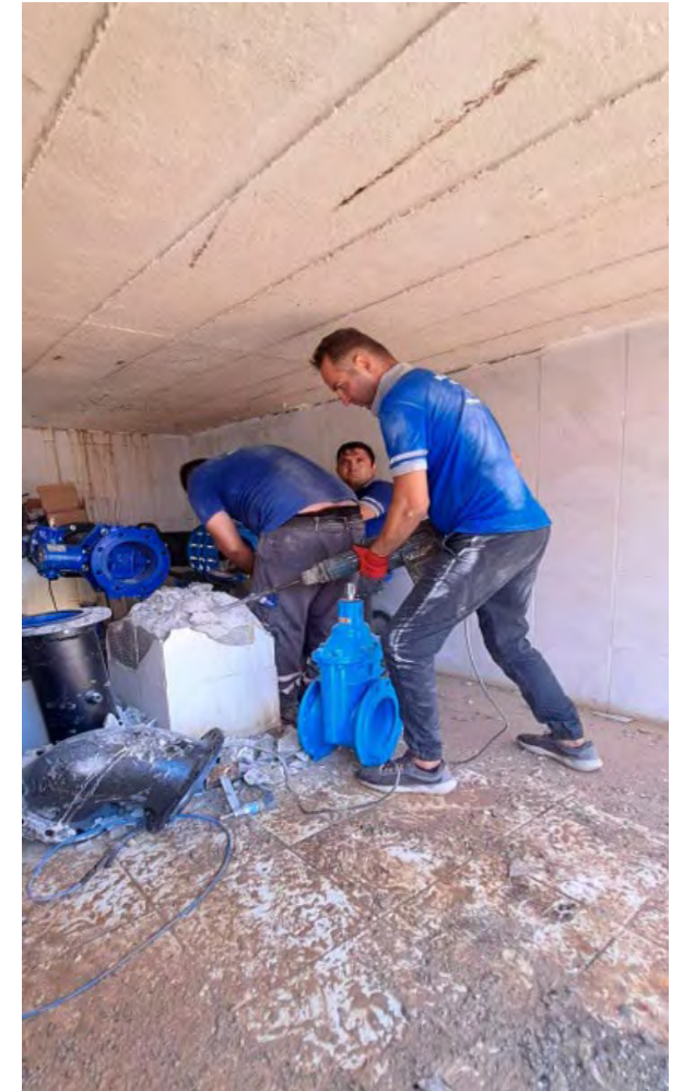
DMA Menhollerinde bulunan enstrüman montajı
