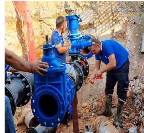
DMA Menhollerinde bulunan enstrüman montajı
