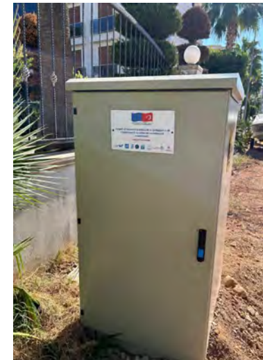
DMA SCADA Harici Kabin
