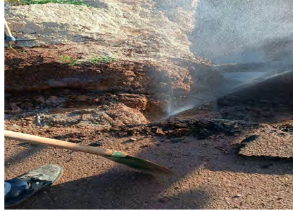
Şekil 23. Döşemealtı İlçesi, Yeşilbayır Mahallesi 516. Sokak Ø110mm PE arıza tespiti.
