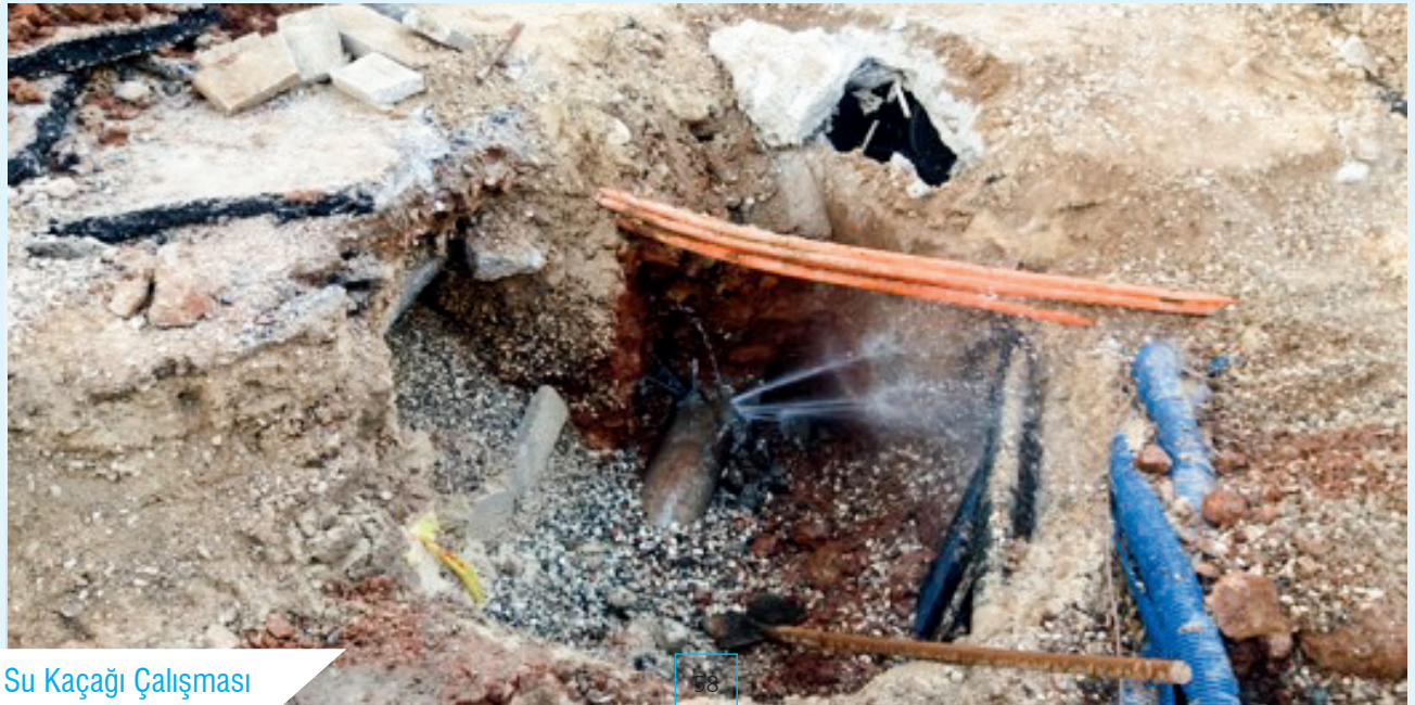
Sistemden tespit edilen patlak noktası
