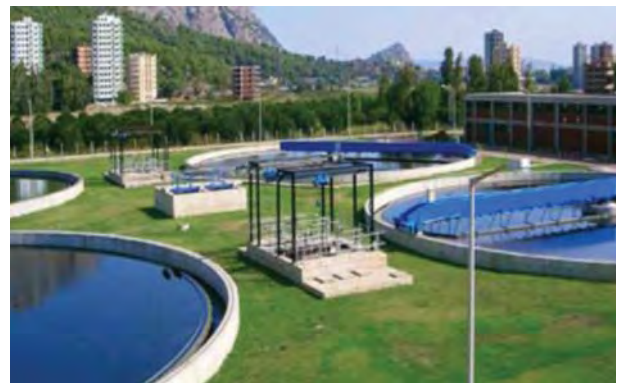
Hurma İleri Biyolojik Atıksu Arıtma Tesisi/ Son Çökeltme Havuzları
