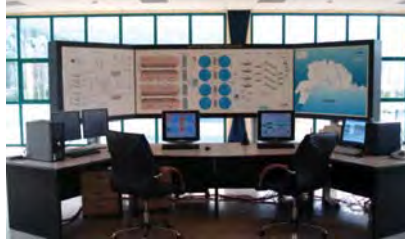
Hurma İleri Biyolojik Atıksu Arıtma Tesis SCADA Kontrol Odası
