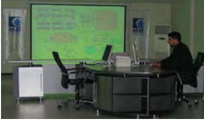
Lara İleri Biyolojik Atıksu Arıtma Tesis SCADA Kontrol Odası
