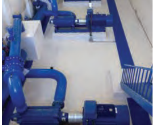
Kaş Saklıkent Pompa
