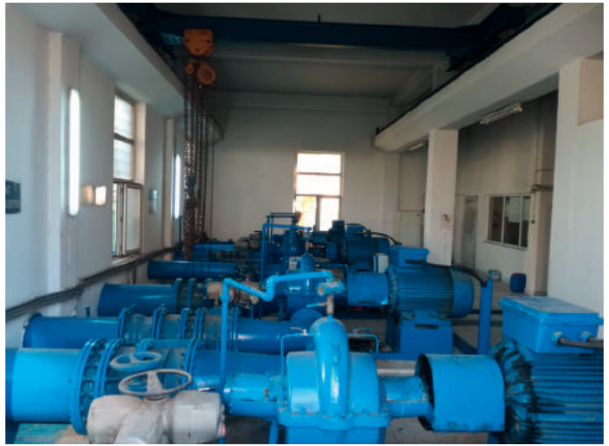
Çağlayan Pompa İstasyonu
