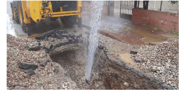
Muratpaşa Soğuksu Mahallesi 311 Sokak. Ø 110 mm PVC Boru Yarık
