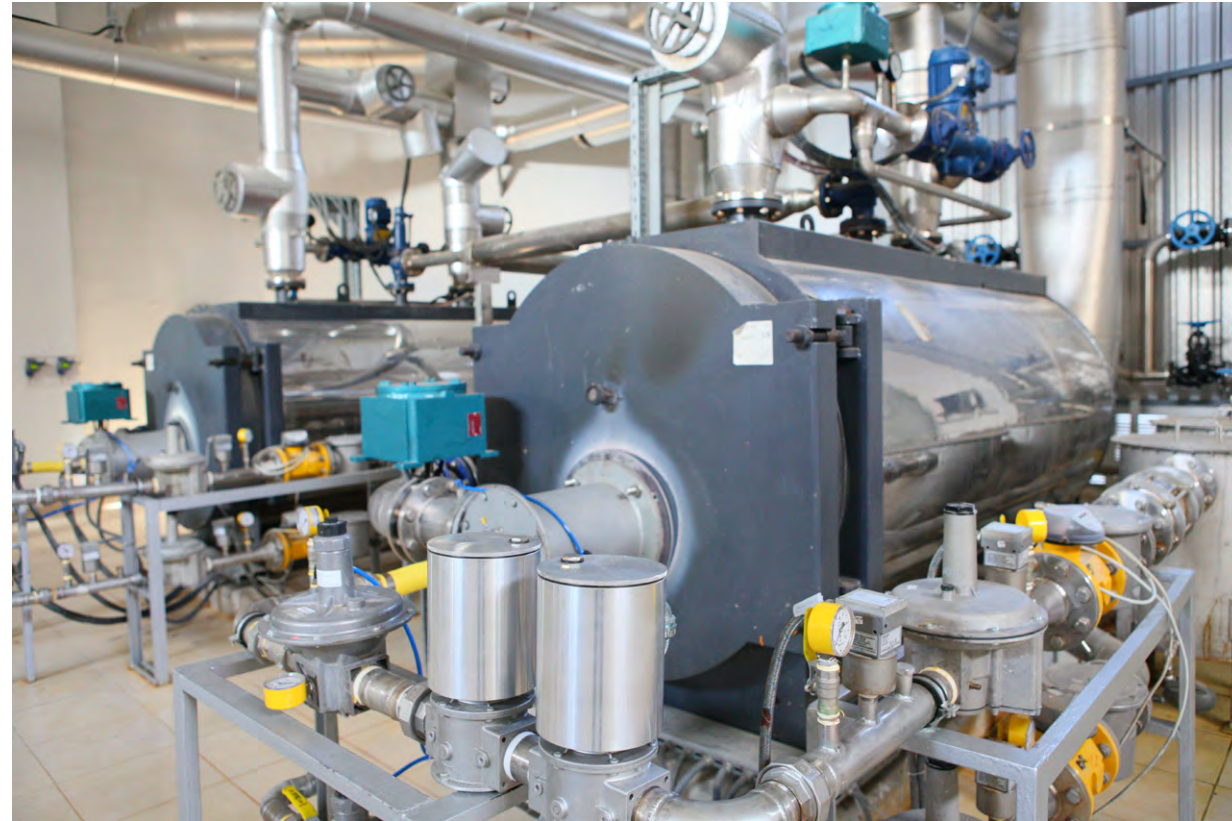
2022 yılı içerisinde yıllık toplam 1,1 milyon m3 biyogaz Çamur Çürütme Tanklarının ısıtılması için kullanılmıştır.
