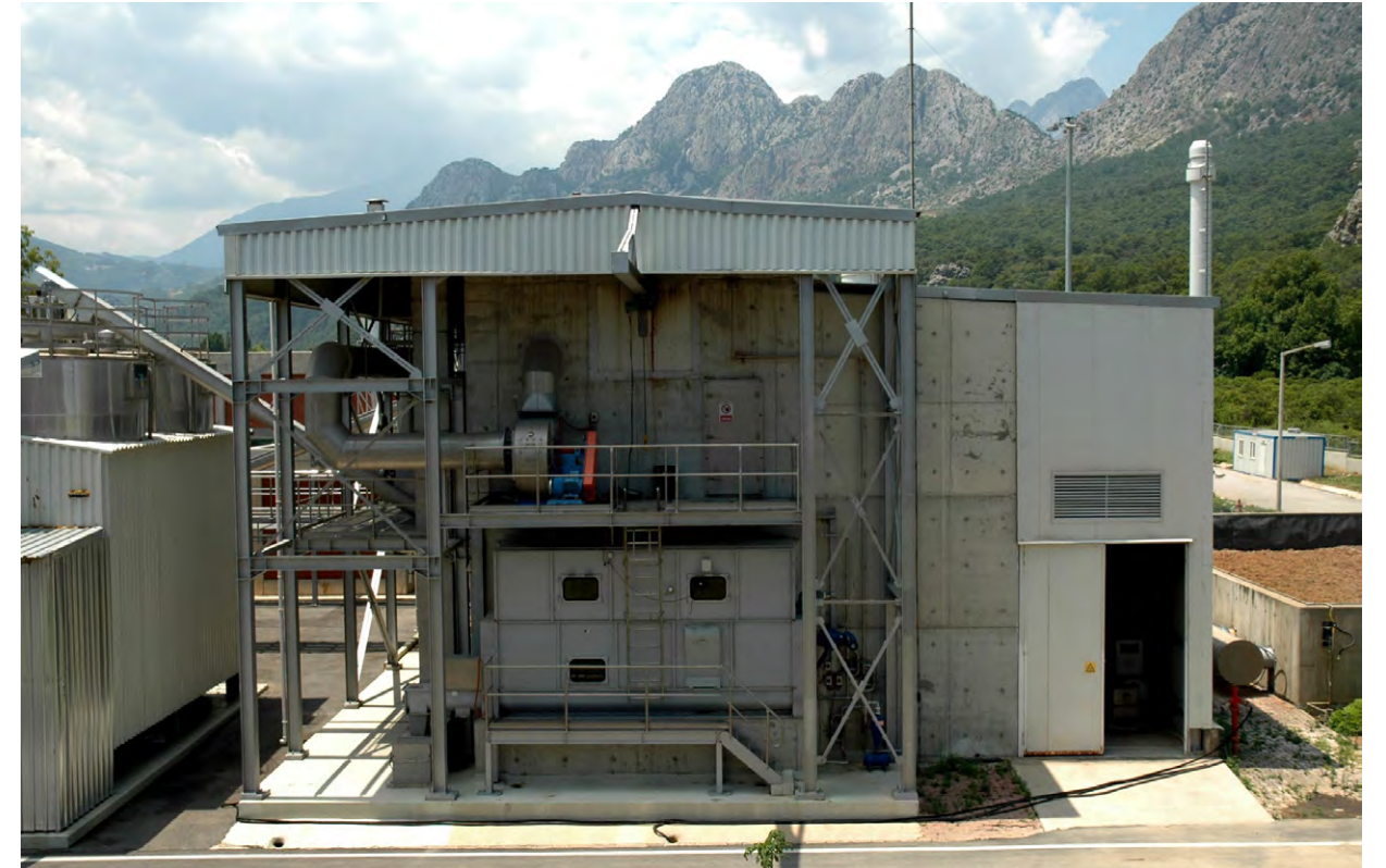
Hurma AAT yerleşkesinde bulunan Termal Çamur Kurutma Tesisinde % 17-20 KM içeriğindeki çamur keki % 92 KM içeriğine kadar kurutulmakta ve çamur hacmi 1/5 oranında azaltılarak daha stabil ve zararsız bir hale getirilmektedir. 2022 Yılı günlük ortalama 90 ton, yıllık toplam 32.850 ton artıma çamuru kurutulmuştur. 2022 Yılında Çimento Fabrikalarına 5.240 Ton kuru ürün satışı yapılmıştır.
