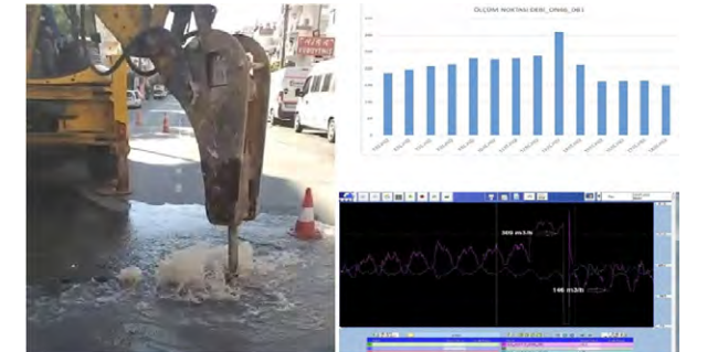
Kepez Kuzeyyaka Mahallesi Göksu Caddesi Ø 110 mm PVC Boru
